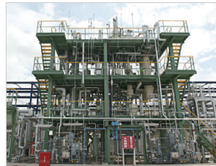
千代田化工建設が建設した小型デモプラント、毎時50m 3 の水素化反応と脱水素反応を繰り返す。
